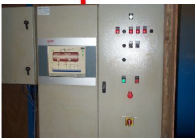
PC industriel à écran tactile intégré sur l'armoire électrique de l'autoclave assurant le contrôle, la commande et la traçabilité du cycle
